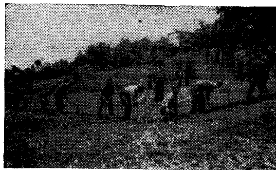
Ἡ βοήθεια τοῦ Στρατοῦ, ὅπως εἰς ὅλα τὰ ἐθνικὰ ἔργα, ὑπῆρξεν ἐξαιρετικῆ. Στρατιῶται μὲ χαρὰν καὶ προθυμίαν σκάπτουν τὰ θεμέλια ἐνός νέου ναοῦ.
